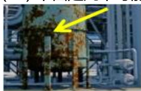
贮罐锈蚀和腐蚀了。
