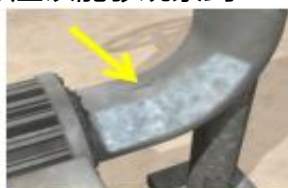
那是管子上的裂缝吗？
